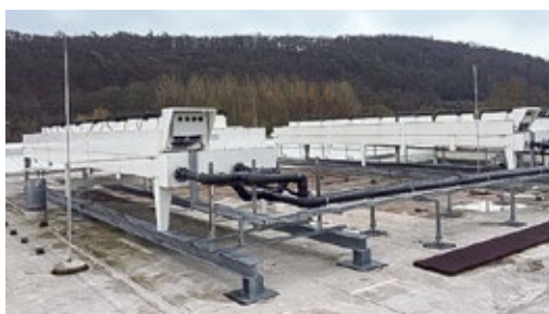
Installation eines Umgebungsluftkühlers auf dem Dach bei GF Piping Systems in Dautphetal (Deutschland).
